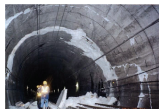
トンネルライニングの崩壊
